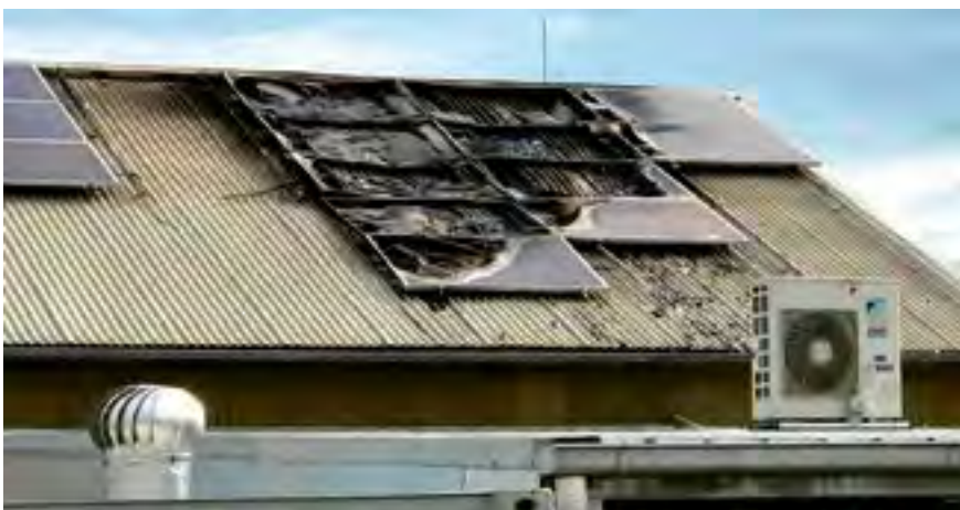
Fig. 13 Incendio fotovoltaico sobre panel no combustible.
