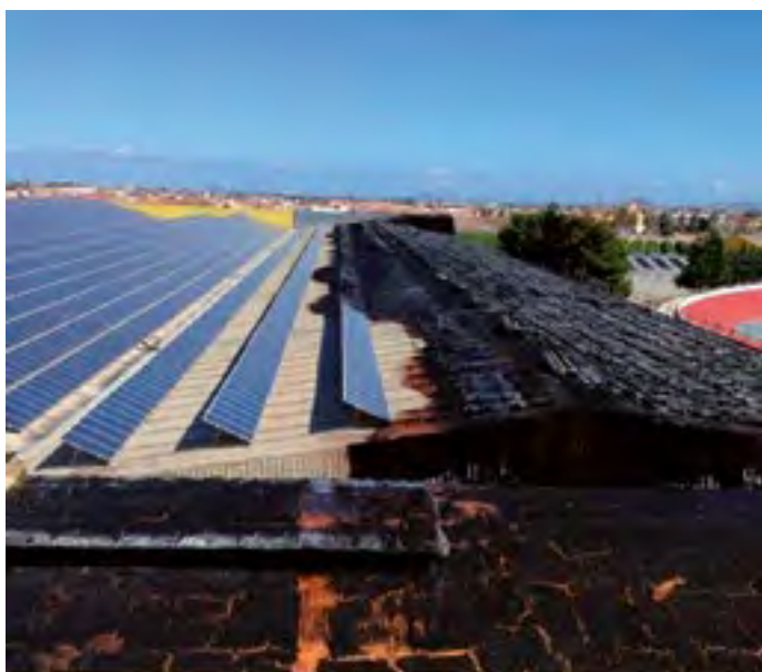
Fig. 14 Incendio en IFEPA.
