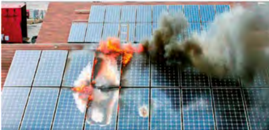
Fig. 19 Incendio tras la formación de un punto caliente.
